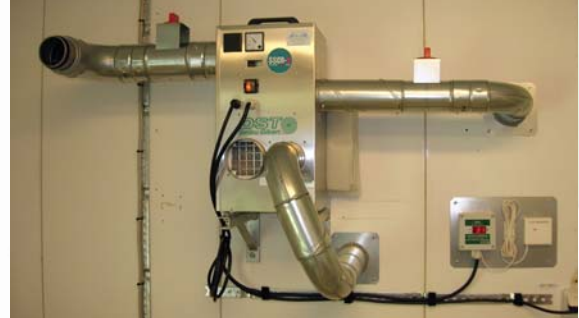
DR-010B varustettuna EH-4 hygrosstaatilla kontrolloi pumppuaseman kosteutta.
